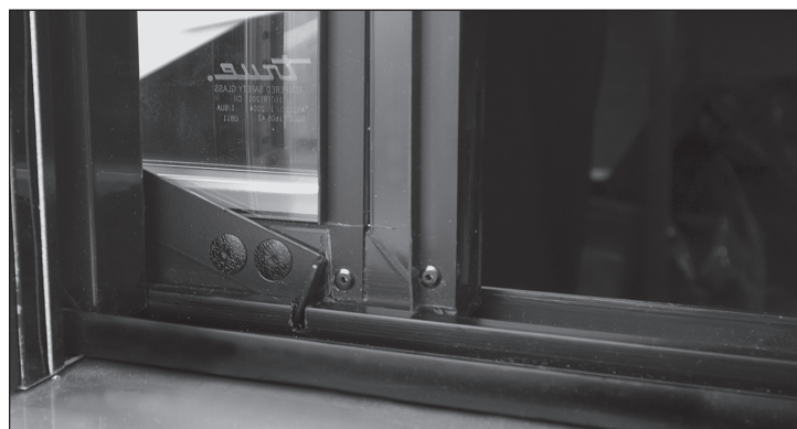
Afb. 1. De deursluiting staat in de geopende stand (vastgeklemd in de inkeping).
