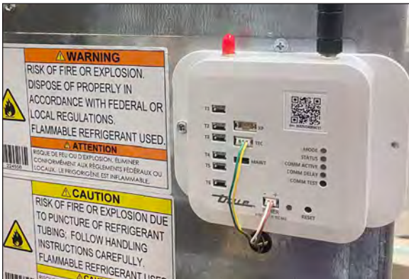
Fig. 2 Cablaggio del cavo connesso al modem. Verde/giallo a TEC; Marrone/Bianco a POWER.
