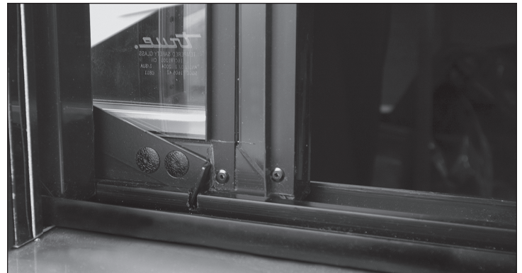
Fig. 1. El pestillo de la puerta está en posición abierta (encajado con la muesca).
