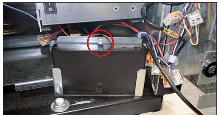
Fig. 3. Emplacement de la vis de la batterie de secours.
